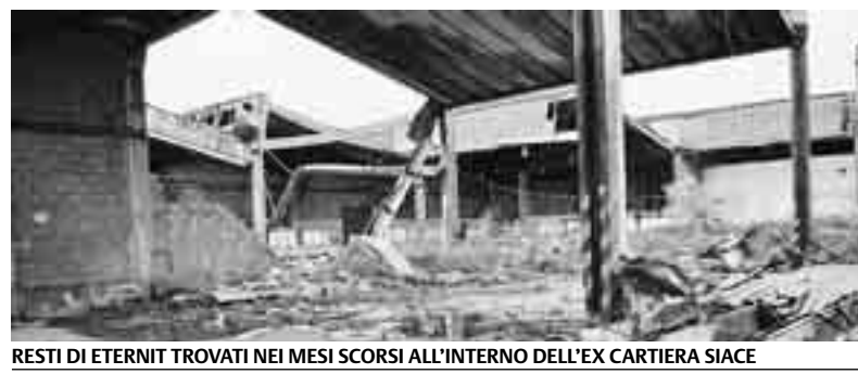
RESTI DI ETERNIT TROVATI NEI MESI SCORSI ALL'INTERNO DELL'EX CARTIERA SIACE
