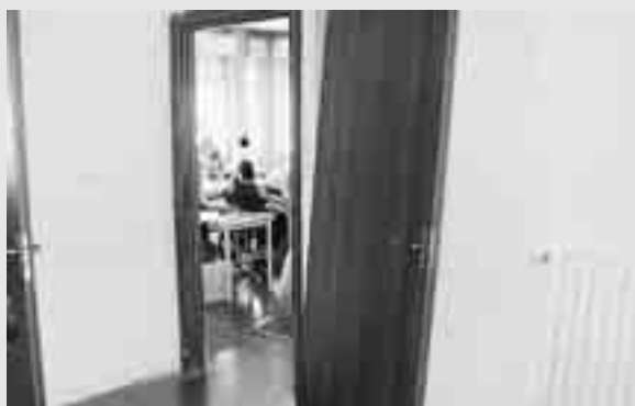
La porta staccatasi. Secondo l'Unità operativa provinciale di igiene pubblica non sono a norma anche i vetri (Foto Di Guardo)
