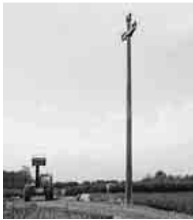
QUI SONO STATI RUBATI I CAVI
